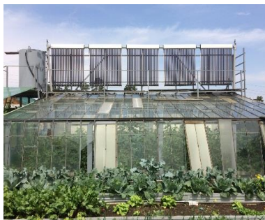
Рис. 3. Группа солнечных коллекторов для энергообеспечения жилого дома (расположение - теплица)
