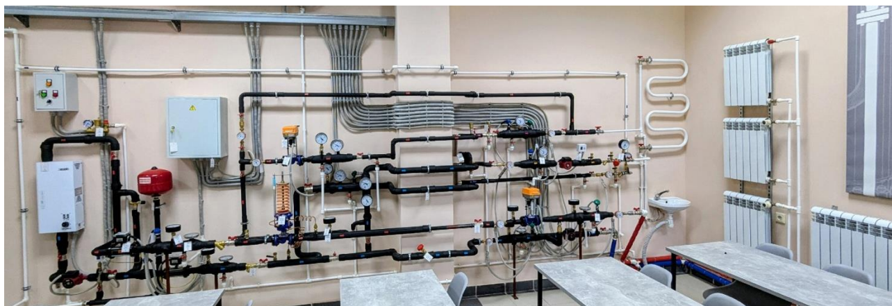
Рис. 1. Индивидуальный тепловой пункт
